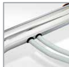
Siisti esiasennus ja kaapelointi plug-in-kytkentää varten
